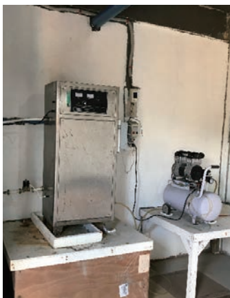
写真 9 オゾン発生装置
