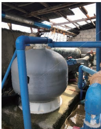
写真 7 砂ろ過タンク
