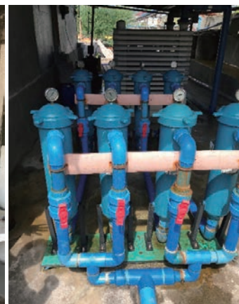
写真 10 バッグフィルター
