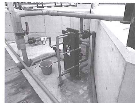
地下水利用の海水冷却装置。夏場の適水温維持に威力を発揮する。
